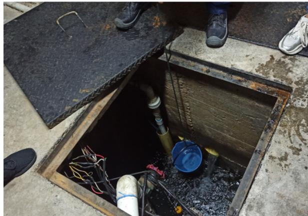
Figura 2. Registro fotográfico de infraestructura de captación.
